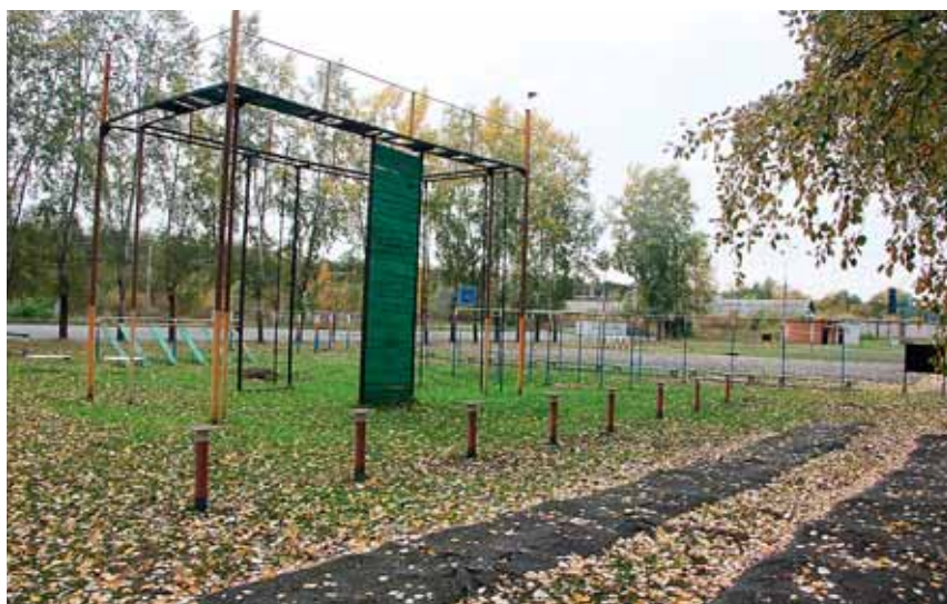
Упадочное состояние спортивной площадки Сборного пункта Военного комиссариата Пермского края: из-за прогнивших конструкций, отсутствия снарядов и вздыбленного асфальта полоса препятствий непригодна к использованию
