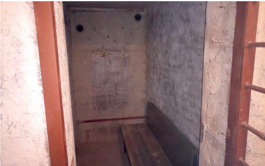
Камера для содержания подсудимых (отсутствует искусственное освещение) в конвойном помещении Нытвенского районного суда Пермского края (псп Оханск)
