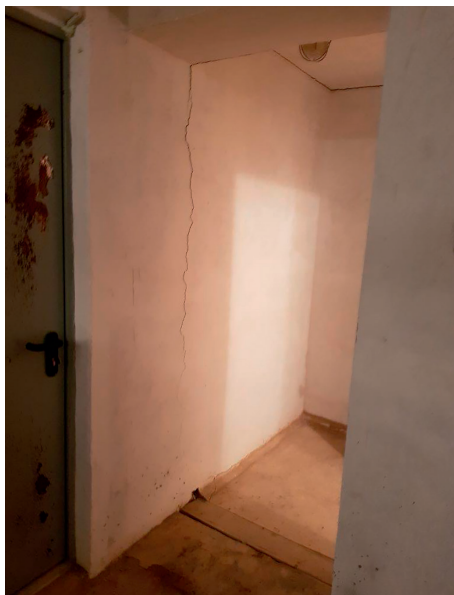
Повреждение стены коридора Косинского городского суда Пермского края
