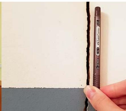
Трещина в стене квартиры специализированного жилищного фонда г. Перми для лиц из числа детей-сирот
