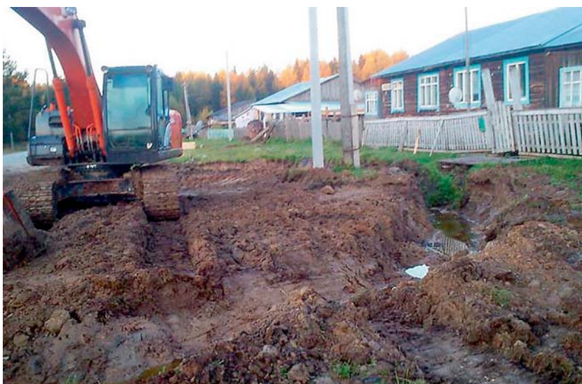
Реконструкция дороги блокировала нормальную жизнедеятельность села Коми-Пермяцкий округ, с. Коса
